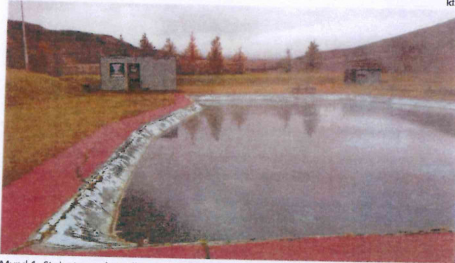
Mynd 1. Steinsteypa í sundlaug má teljast ónýt
